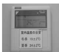
照片 1 病房空调的操作面板
